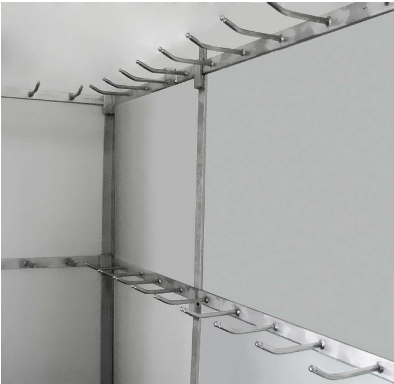
Ανοξείδωτα τσιγκέλια στο εσωτερικό ψυκτικού θαλάμου κρεάτων | Inox hooks inside a cold room for meats
